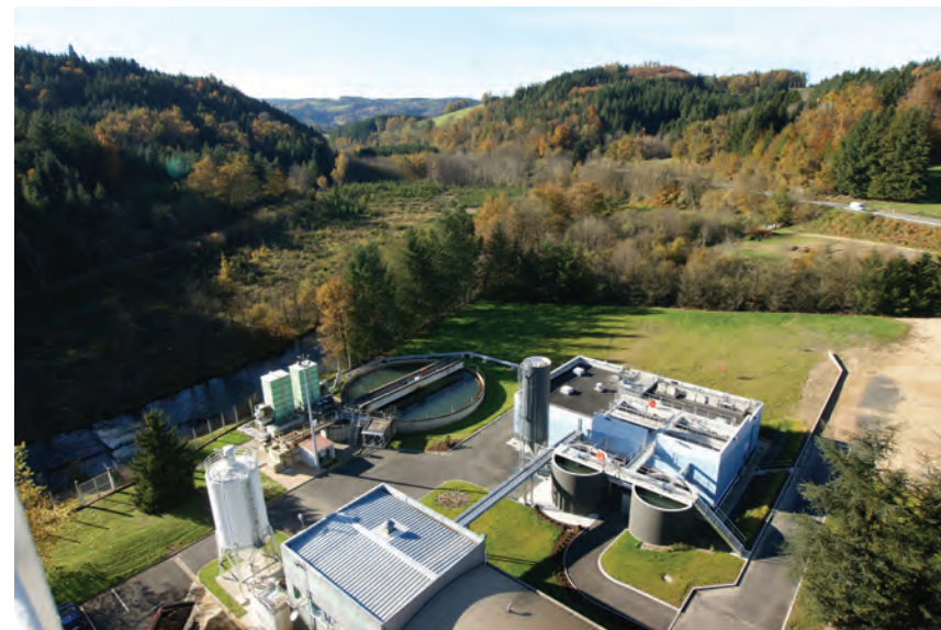
Traitement quaternaire par lit fluidisé de charbon actif pour une usine de synthèse organique à Vertolay (France)
