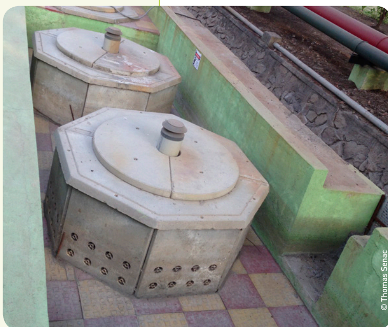
Système de récupération d'eau de pluie sur un site Sanofi en Inde
