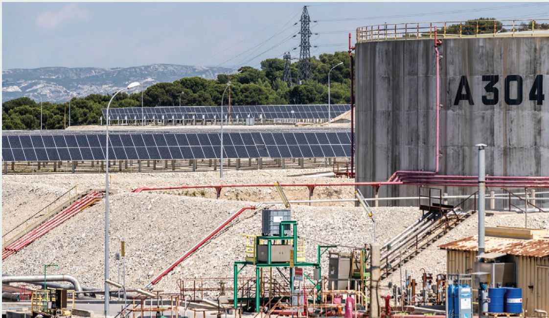
Vue partielle de la ferme solaire et des cuves de stockage (Raffinerie de la Mède)
