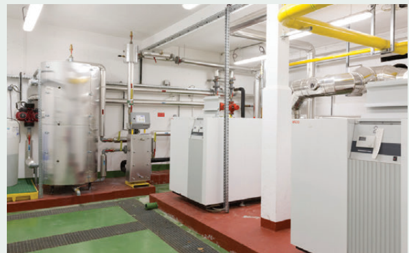
Chaufferie Engie à Ris Orangis (91)
